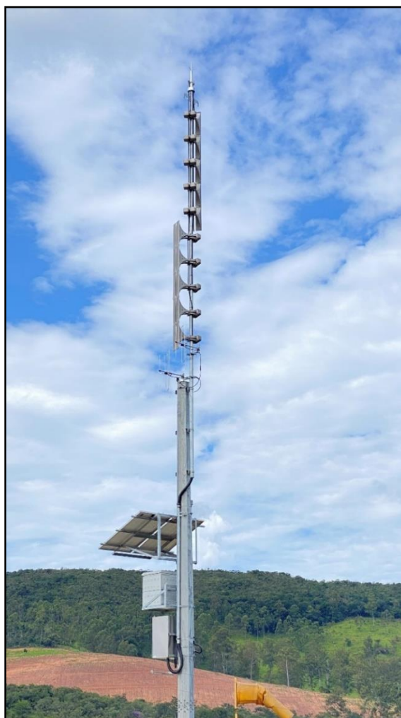
Figura 11.1 – Sirene implantada próximo a ZAS da mancha de inundação da Barragem B4
